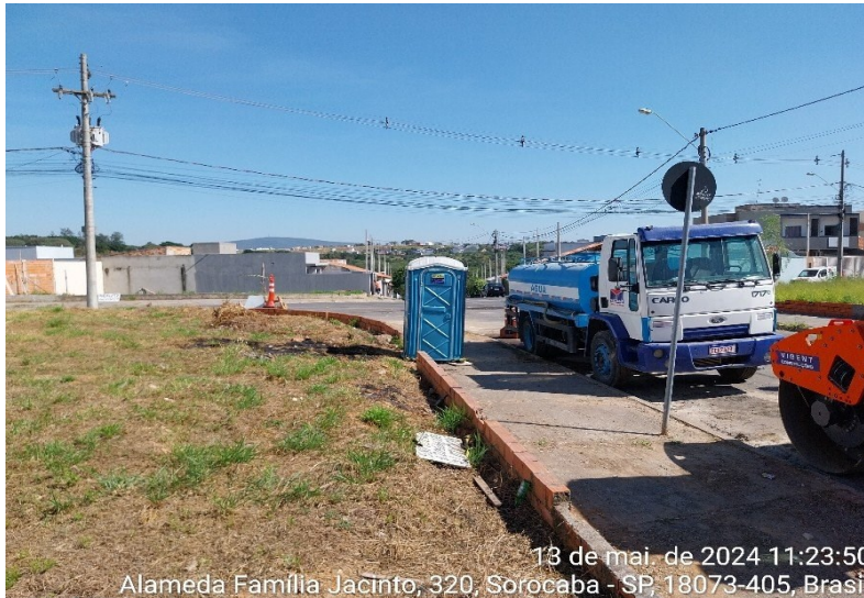
Foto 1 - Banheiro Químico na Frente de Serviço
